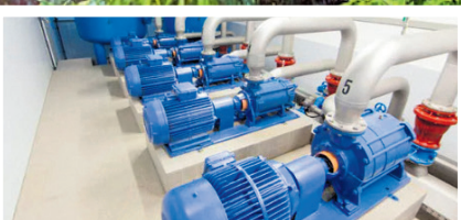
BOMBEIGS I FILTRATGES
